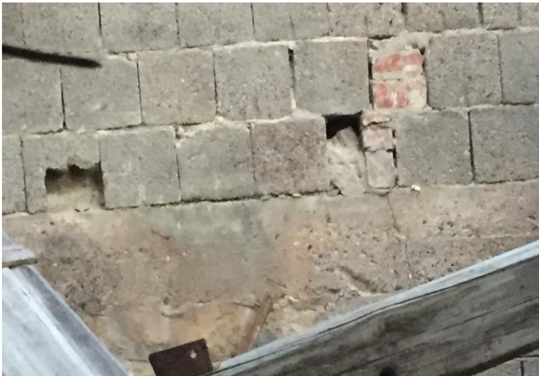
Abb. 4: Altes Betriebsgebäude, Spalten/Hohlräume, Westseite
